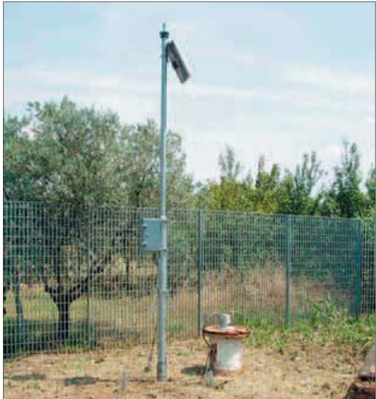
Stazione automatica di monitoraggio freaticometrico (Pozzo 5A - Acquifero costiero tra fiume Fine e Cecina)
